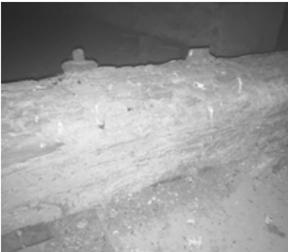
La poutre centrale maintenant le plafond sur toute la longueur est bien atteinte
